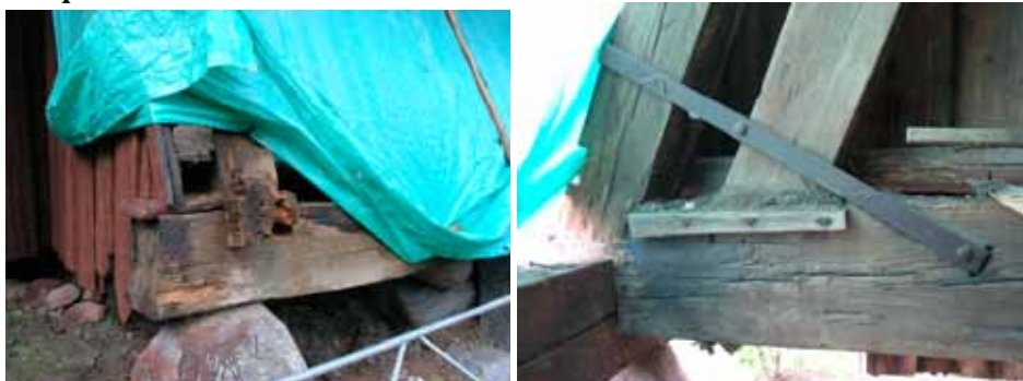
Bjälken hade långt gångna rötskador i yttre delen. Stolpparet var däremot i gott skick. Södra syllan var rötskadad på flera ställen och byttes ut i sin helhet. Lp20110020 och Lp20110021.
