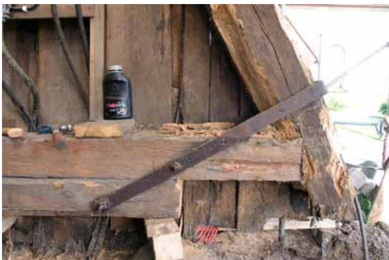
Rötskadade delar av anslutande bjälke avlägsnades. Lp20110041.
