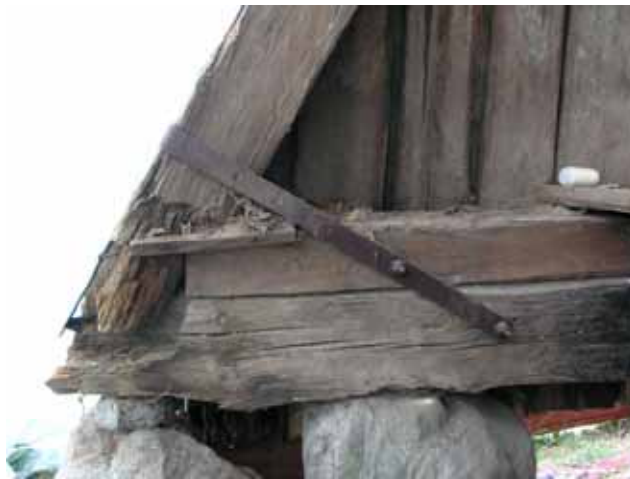
Både stolpe och anslutande stolpe hade rötskador i nedre och yttre delarna. Lp20110047.
