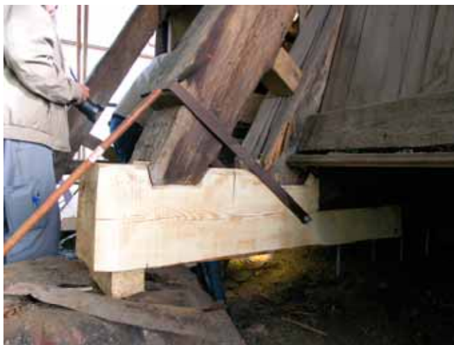
Stolparna var i gott skick och lämnades utan åtgärd. Den anslutande bjälken lagades i yttre delen. Från syd. Lp20110027.
