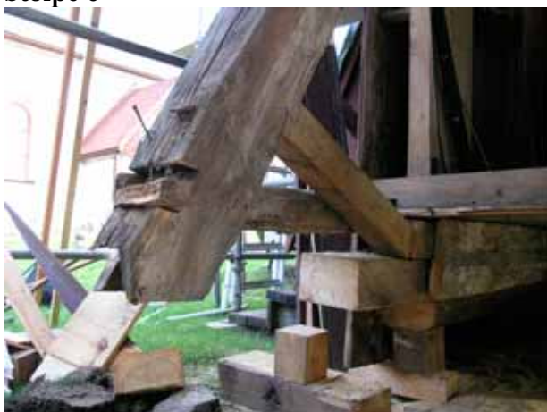
Stolpen var i gott skick och lämnades utan åtgärd. Anslutande bjälke var rötskadad i yttre delen och lagades. Lp20110028.
