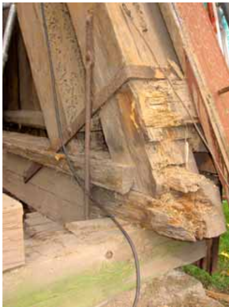
Rötskadorna till trots kunde hela stolphörnet bevaras. Lp20110032.
