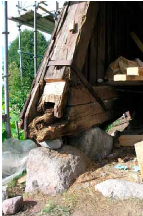
Stolphörn 3 före lagning. Lp20110048.
