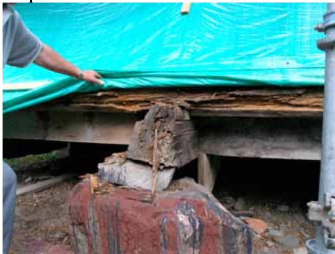
Bjälken under stolppar 8 hade kraftiga rötskador i yttre delen. Lp20110025.
