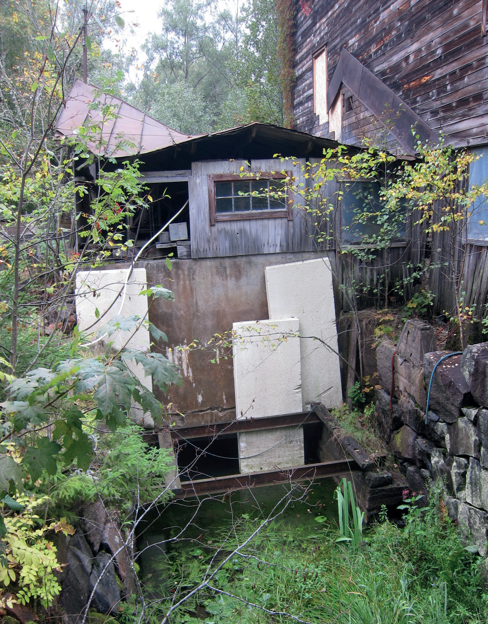
Turbinhuset i Karlösa har förfallit svårt, sedan yttertaket för några sedan gav vika. Foto: Moa Beskow.
